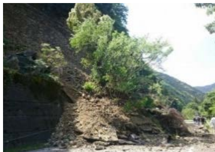
写真①: 土砂崩れによる通行止め状況 (H28.5.4 新宮市熊野川町相須)
