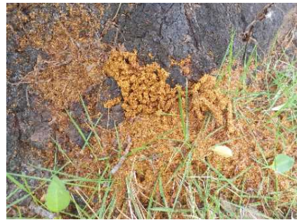
フラスの発生状況
